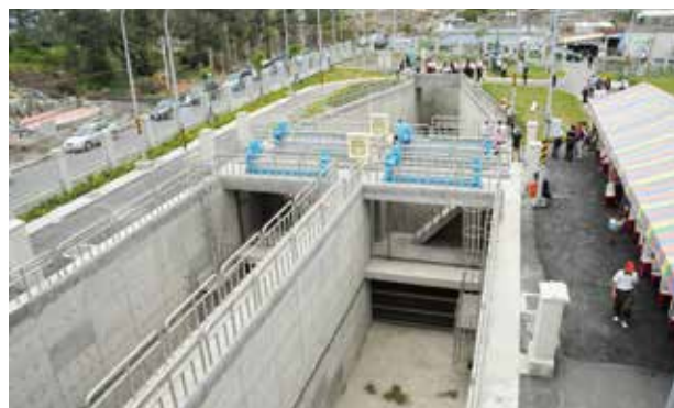
塭豐養殖區海水統籌供應系統為目前全國規模最大且建造經費最高之養殖海水供水設施。
