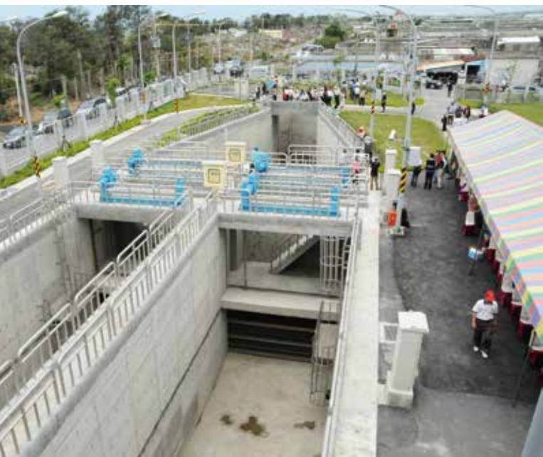
塭豐海水供水站可引導漁民轉型成海水養殖集中區域，有效改善地層下陷的情形。(攝影/施玉惠)
