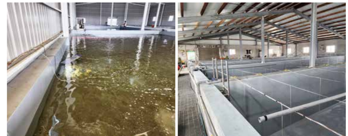
養殖區循環水設施
