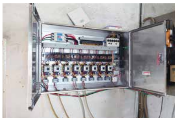
魚塭智慧電箱，自動（遠端）控制增養機等機具運作
