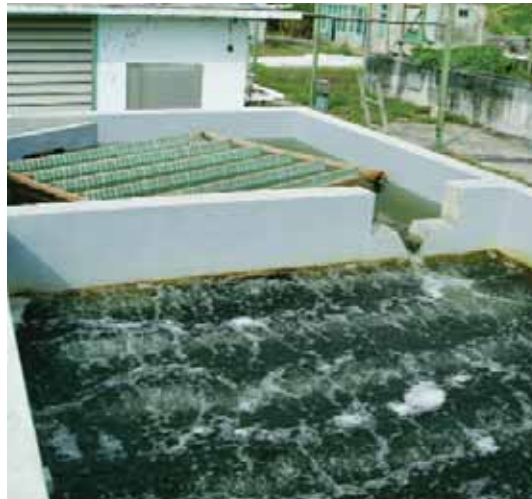
• 室外循環水-斜板沈澱及濾槽
